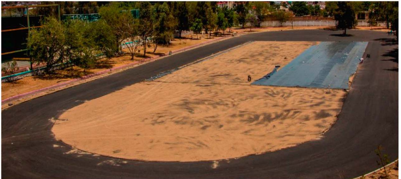
Continúan los trabajos de rehabilitación de la pista de atletismo y la construcción de la cancha de usos múltiples de pasto sintético en la unidad Ángel 'El Zapopan' Romero.
